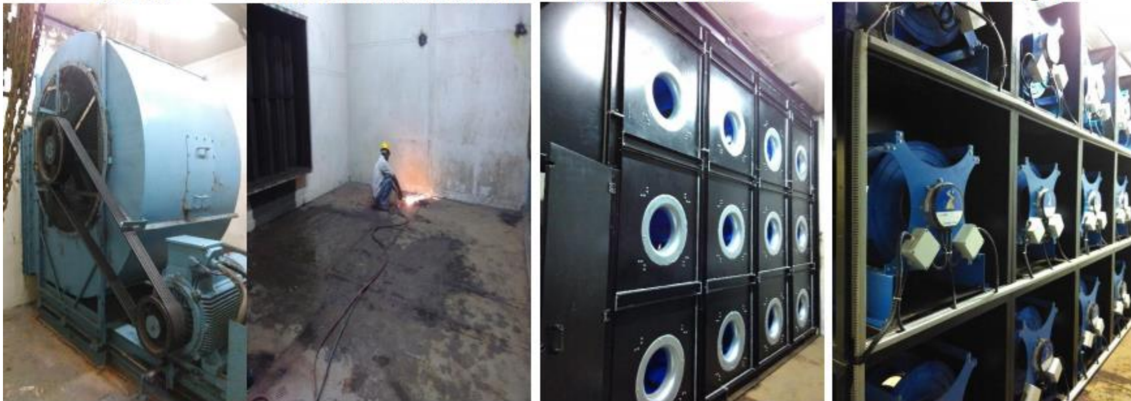
New EC fan discharge Side
